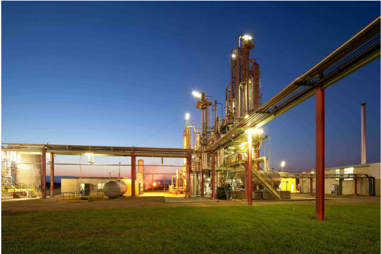
Speichim Processing à St Vulbas (France)
